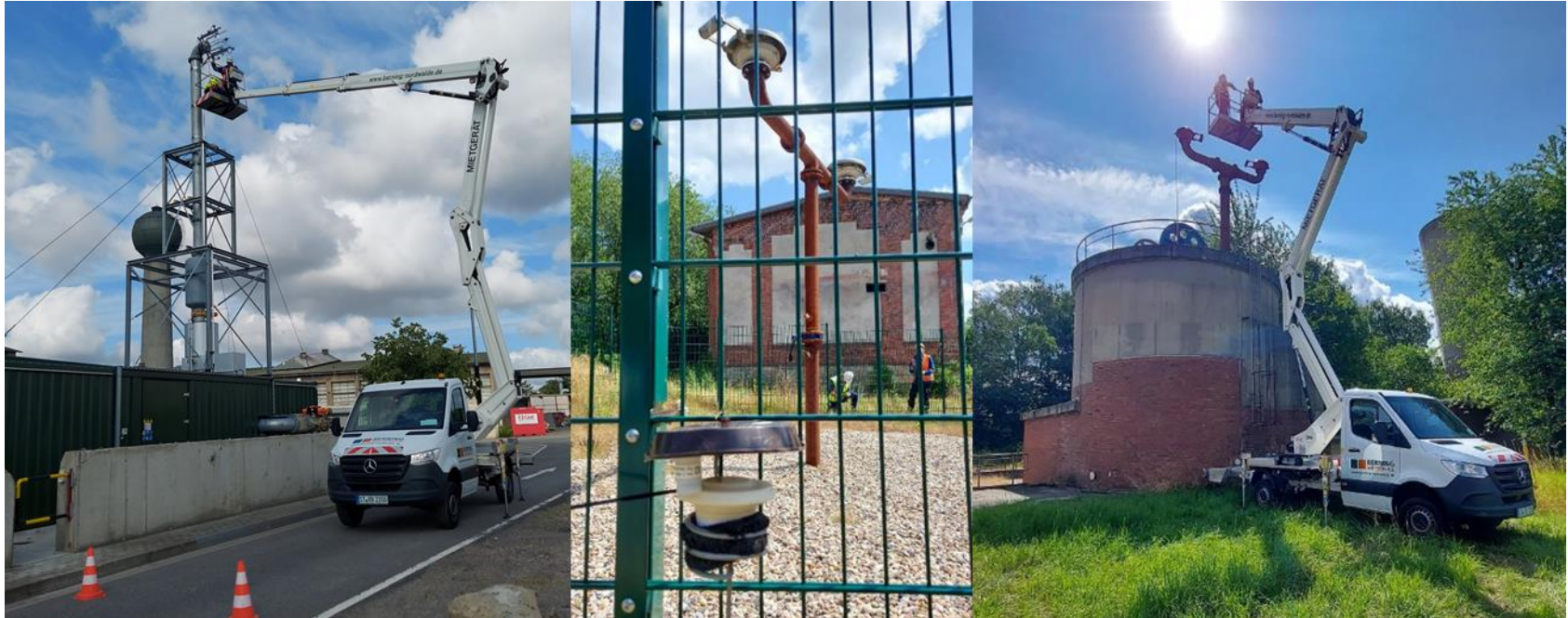
Installation der Messgeräte an der Grubengasentlastungsanlage am Schacht Oeynhaus 2, Theodorschacht und Bockradener Schacht (v. l. n. r.).
