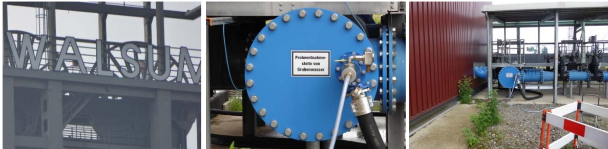
Abbildung 25: Grubenwassermessstelle Duisburg Walsum, Druckrohr
