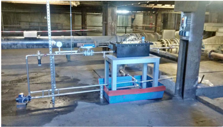
Abbildung 4: Installationen des Schwebstoffsammelkastens auf Prosper Haniel
