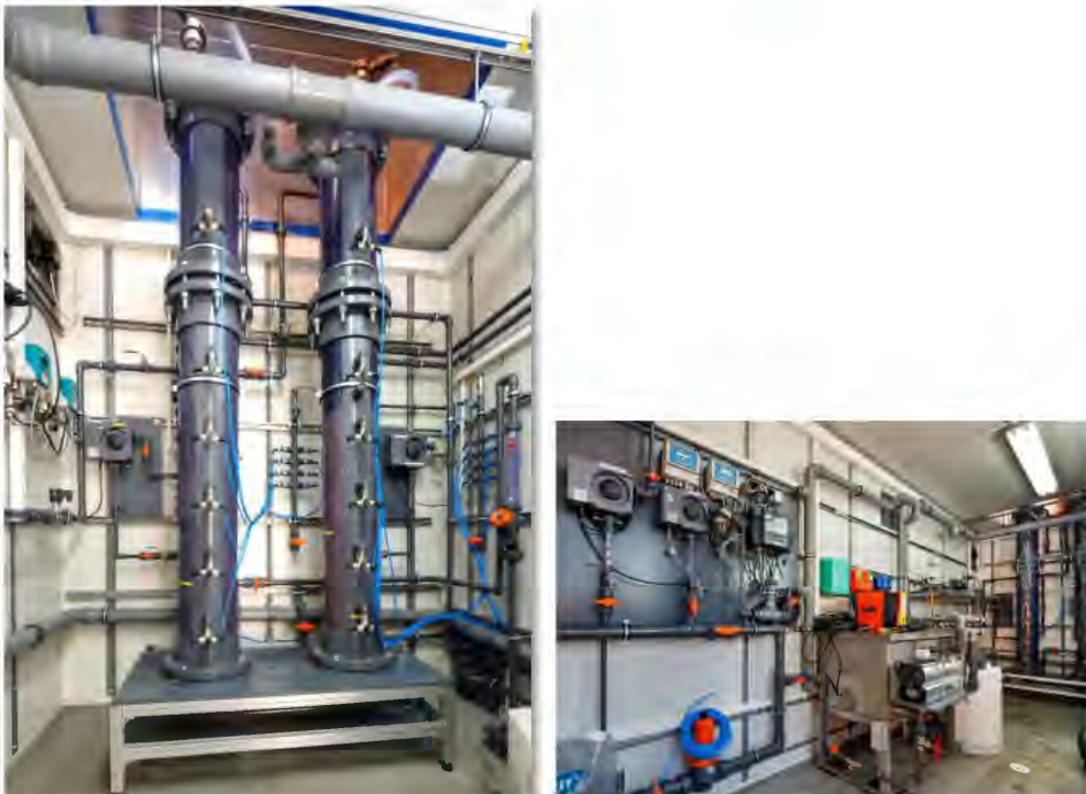
Abbildung 5: Innere des IWW-Versuchscontainers mit Filtersäulen, Flachbelüfter und Messgeräten
